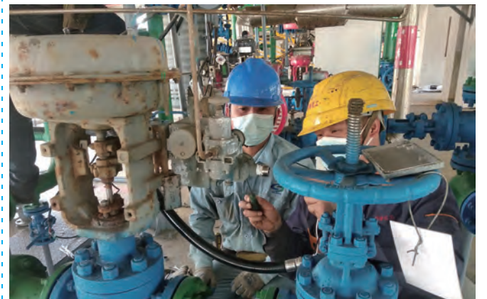
连日来，利海化工公司充分利用氯化苯二期装置短停间隙进行安全整改，2天时间保质保量完成了200余处原有仪表管线更换成防腐级软管工作，有效消除了生产设备上的安全隐患。（许小宝）
